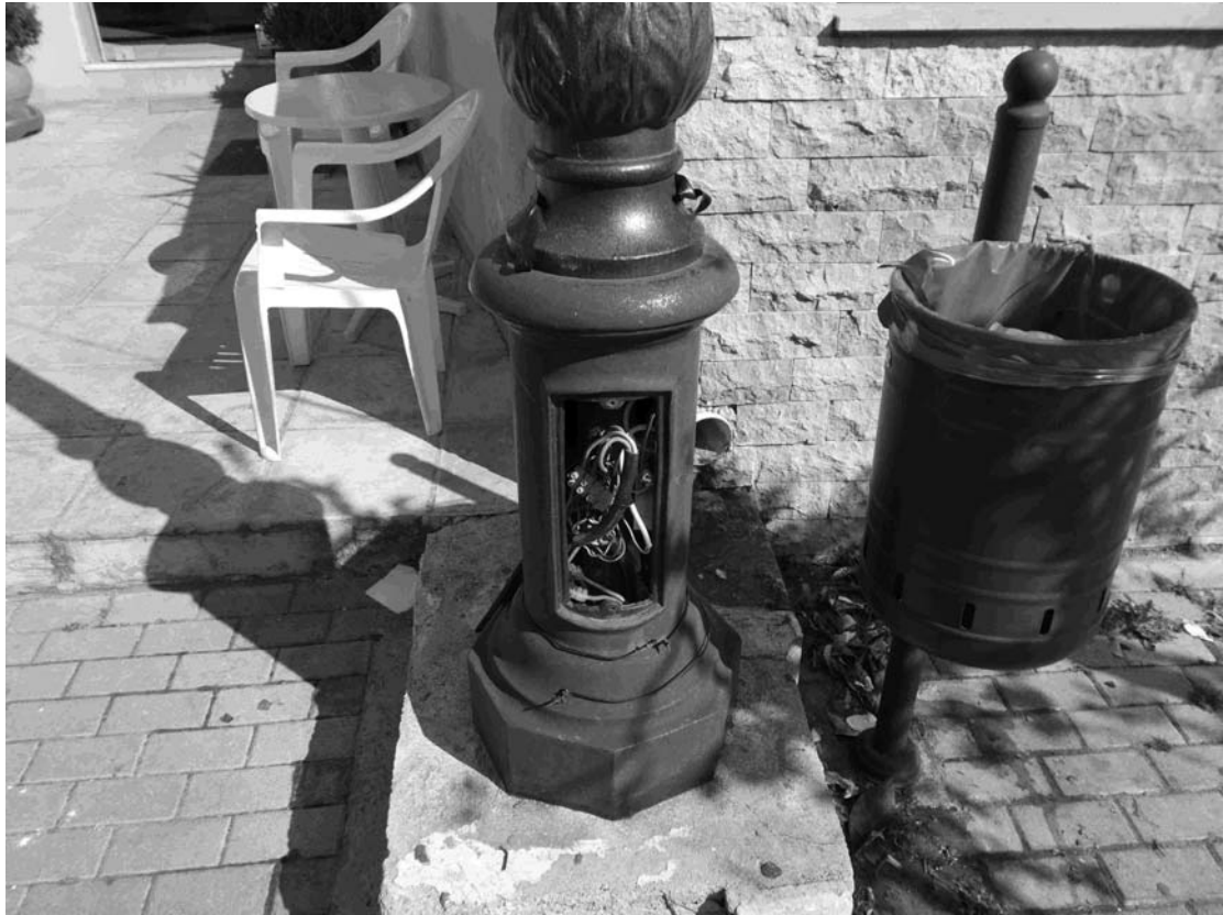
Φωτογραφίες 19 - 20. Λ. Κρυονερίου Δ.Ε. Κρυονερίου: Μεγάλο πορτάκι ιστού.
