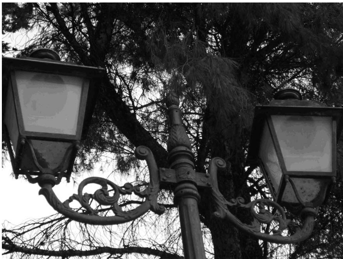
Φωτογραφία 8. Ηρώων Πολυτεχνείου Δ.Ε. Αγίου Στεφάνου: Μπράτσο και φωτιστικό φανάρι Na 70W.
